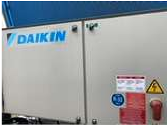
Foto 6 Geïnstalleerde topkoeling (kantoor) met koudemiddel R32
