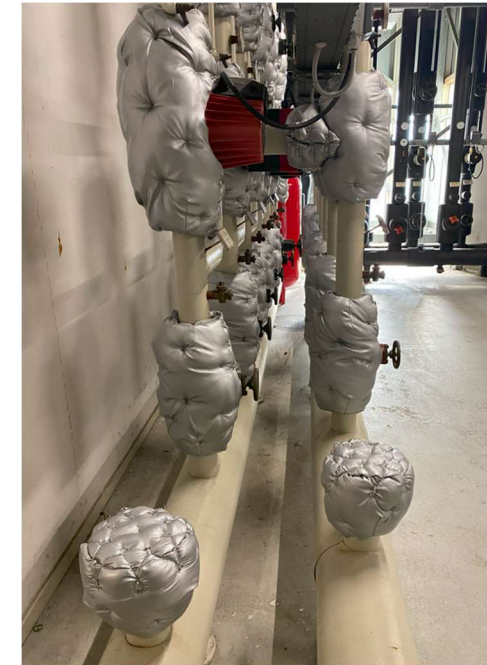
Foto 3 Isolatiemoffen appendages verwarmingsinstallaties (zolder kantoor) – EML maatregel
