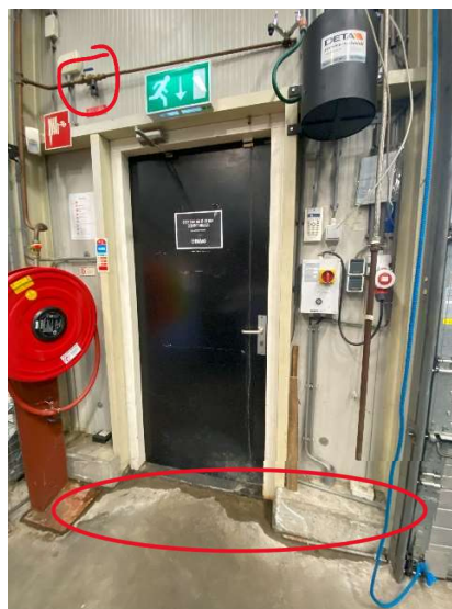
Foto 2 Lekkage leiding brandhaspel Magazijn
